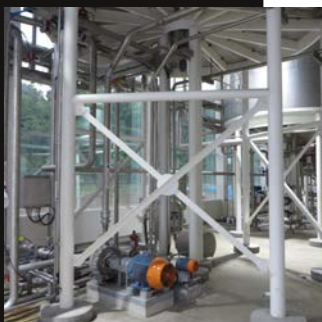
Die Technik im Erdgeschoss
